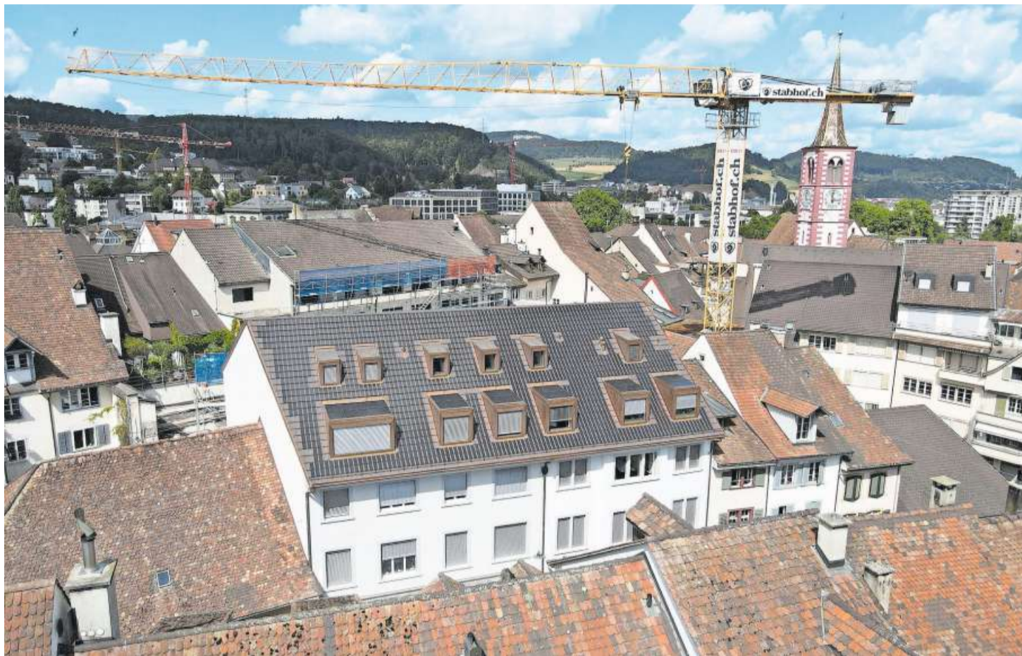
Solaranlage auf dem Stabhof im historischen Stedtl von Liestal: Erlaubt, weil nicht einsehbar.
