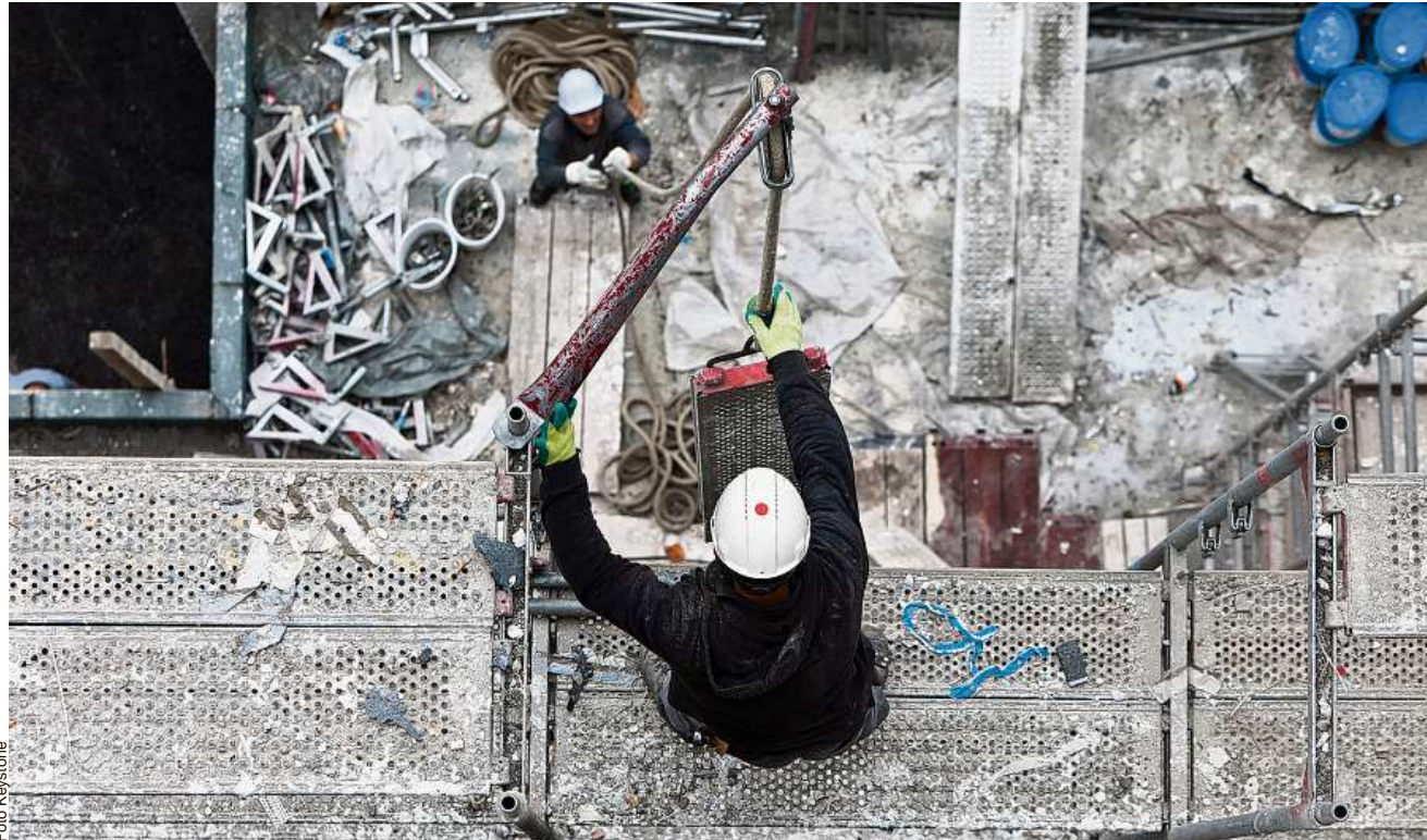
Harmlose Strafen. Das Überreizen der Bauvorschriften ist Alltag. Wer erwischt wird, muss schlimmstenfalls rückerbauen.
